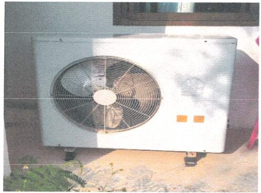
๒. เครื่องปรับอากาศ
