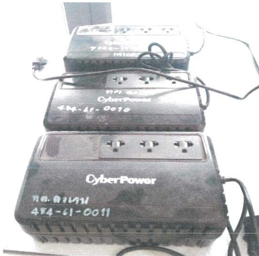
๒๑. - ๒๓. เครื่องสำรองไฟ
